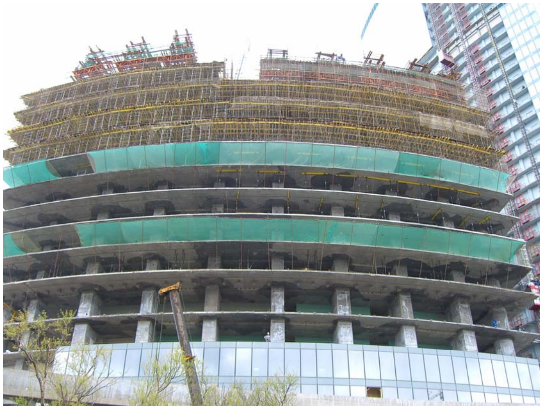
Рисунок 14 – Устройство защитного ограждения при строительстве высотного здания
