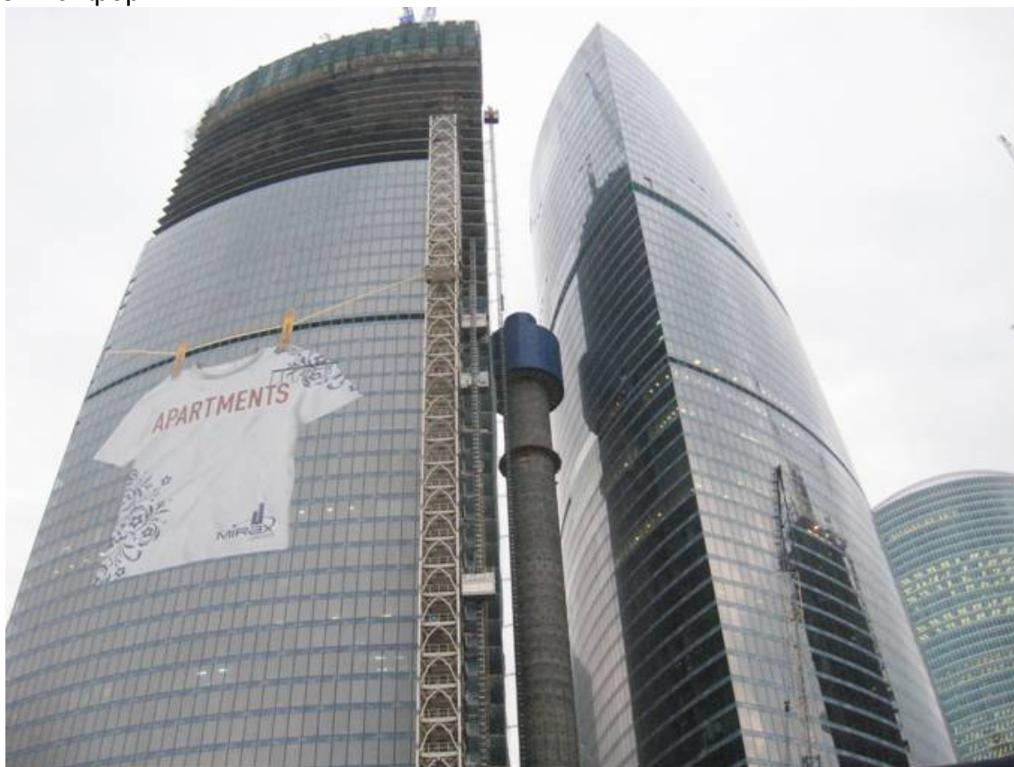
Рисунок 10 – Совмещение работ по устройству каркаса и фасада здания (г. Москва, Россия, 2008 г.)
