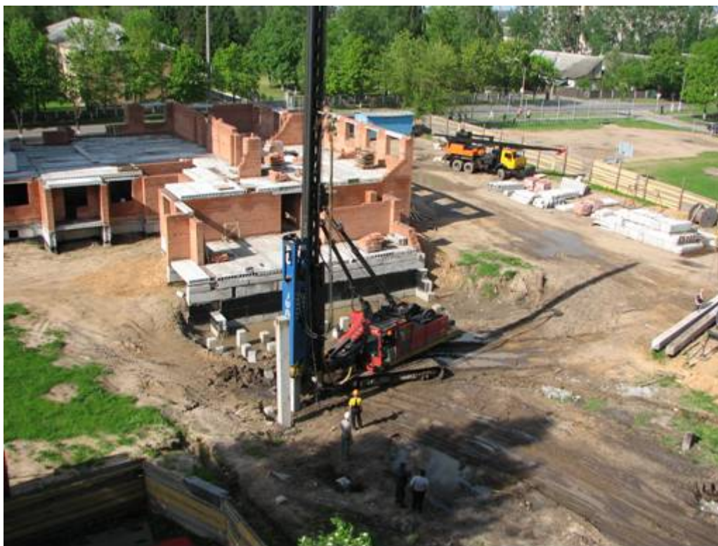
Рисунок 7- Пробная забивка свай (с помощью гидравлического молота JUNTTAN) на объекте «20-квартирный жилой дом ЖСК «Энергетик-БЭС» по ул. Л. Чаловской в г. Борисове»
